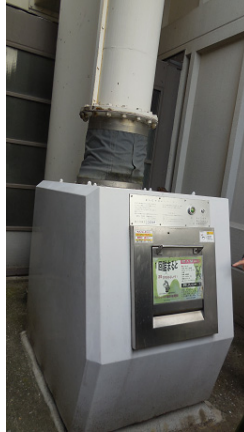
写真 9：ゴミ投入口 (1階設置部)
