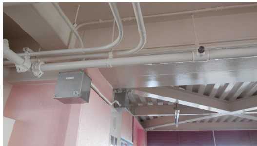
写真 13：階段室前の防火戸の代わりに設けたドレンチャー
