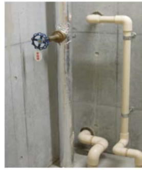
写真1 スプリンクラー元栓
