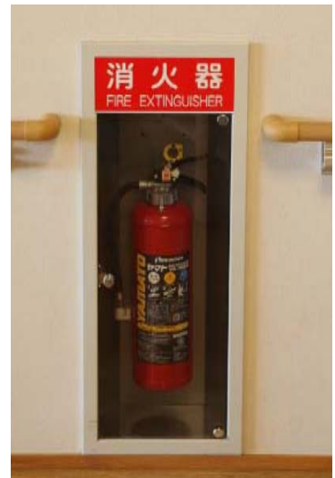
写真5 設置されている消火器
