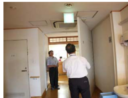
写真2 閉鎖障害のある防火扉
