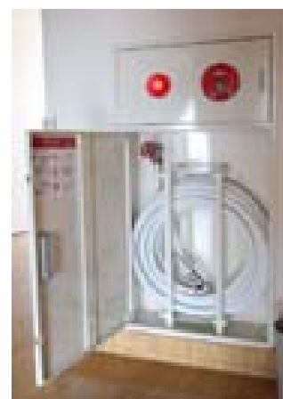
写真3 消火栓のホース
